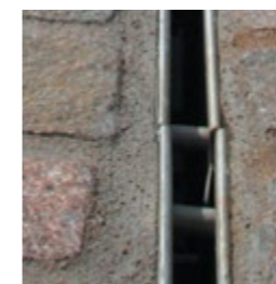
Grelha ranhurada ACO Brickslot instaladas sem o clip conector
